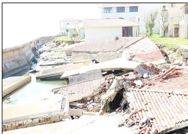
Ảnh 1. Bờ biển bị xói lở mạnh ở khu vực Phước Hải, phường Cửa Đại, tỉnh Quảng Nam (ảnh Hoàng Ngô Tự Do, 2016)
